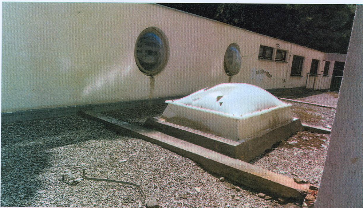
14. Ravni krov iznad restorana u prizemlju – polupani svjetlarnici, oštećena izolacija kao i nepostojanje kvalitetne odvodnje dovode do po konstrukciju nepoželjnog ulaska vode u unutrašnjost objekta.
