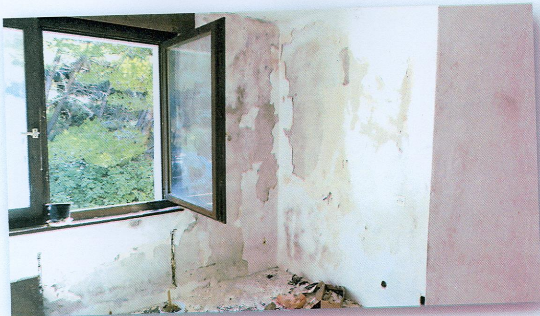
8. Na zidovima soba je vidljivo djelovanje vlage. Oluci su demontirani i ne postoji odvodnja
