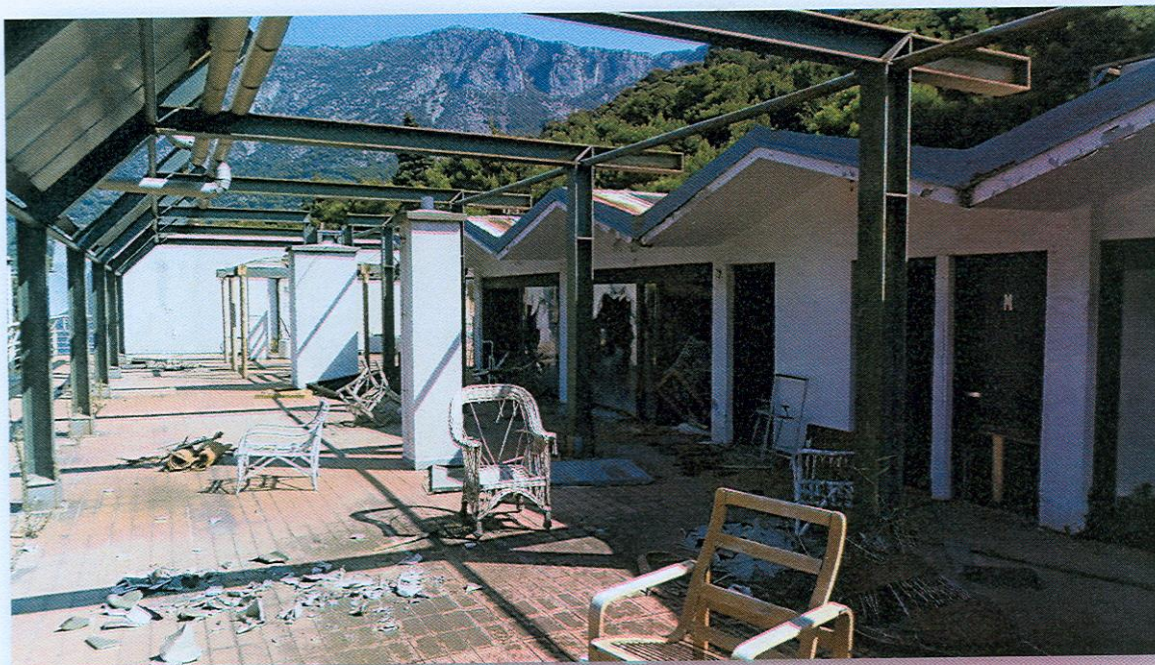
10. Izgled krovne terase- prije devastacije izuzetno atraktivna krovna terasa danas zbog djelovanja vandala nije nimalo reprezentativna. Iznad izdvojenih apartmana je vidljiv dotrajali krovni lim
