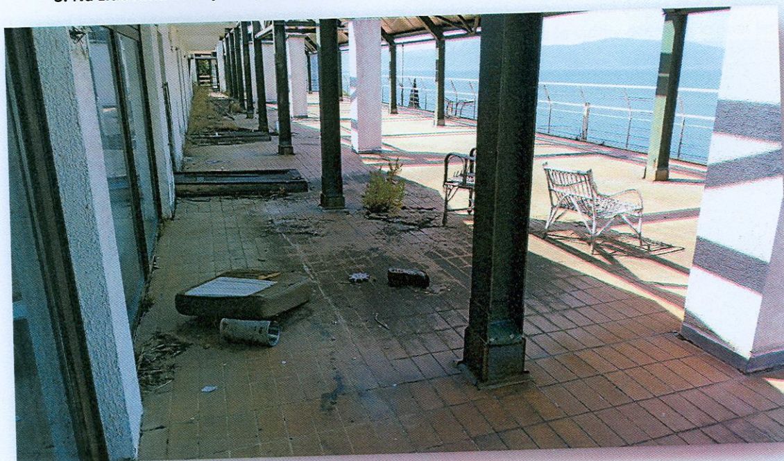
9. Krovna terasa- na ploči terase su uočljivi značajni ugibi. Na stropu etaže ispod vidljivi su tragovi vlage. Zbog djelovanja vlage armatura u nosivoj konstrukciji je ugrožena. Pravo stanje stvari moguće je utvrditi tek otvaranjem konstrukcije. Na krovu je potrebno što prije izvršiti rekonstrukciju!
